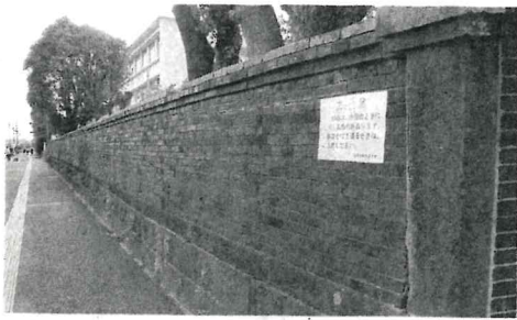
延岡市の岡富中学校南側にある「からみレンガ塀」。28日から注意を喚起する張り紙を掲示している
